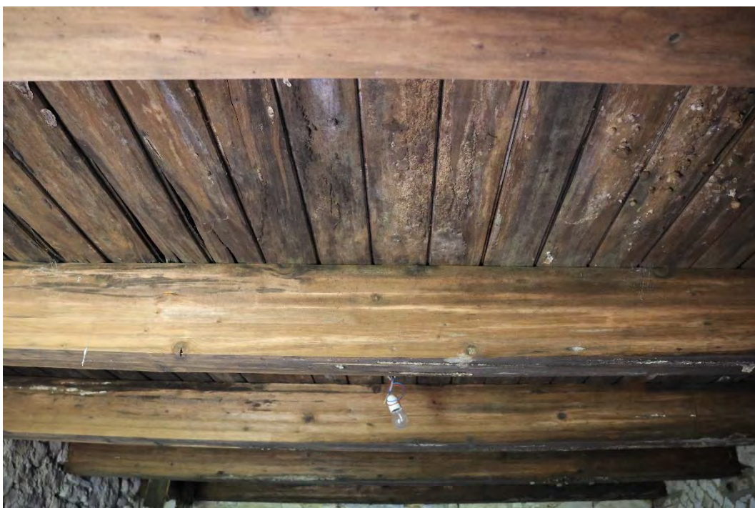
Figura 11: Solaio al primo livello; forte inflessione delle travi lignee.
