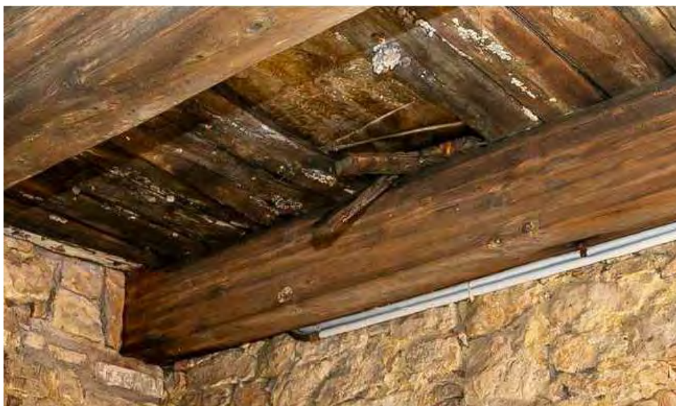
Figura 10: Solaio al primo livello: deterioramento del tavolato esistente.
