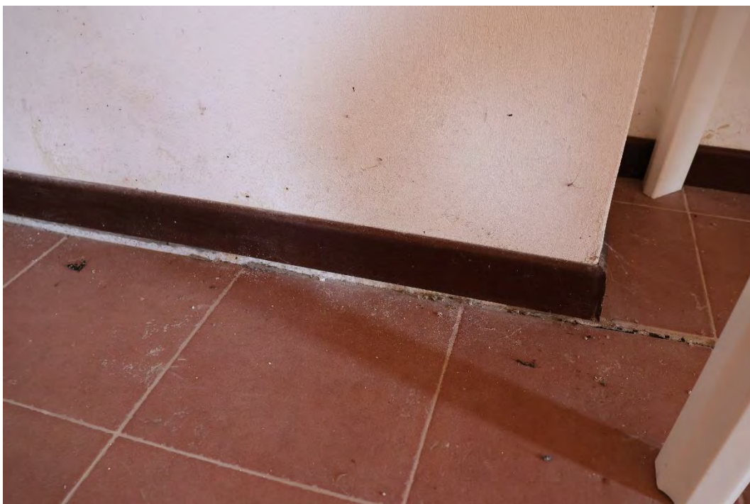
Figura 12: Cedimento perimetrale dovuto al deterioramento localizzato delle travi in appoggio.
